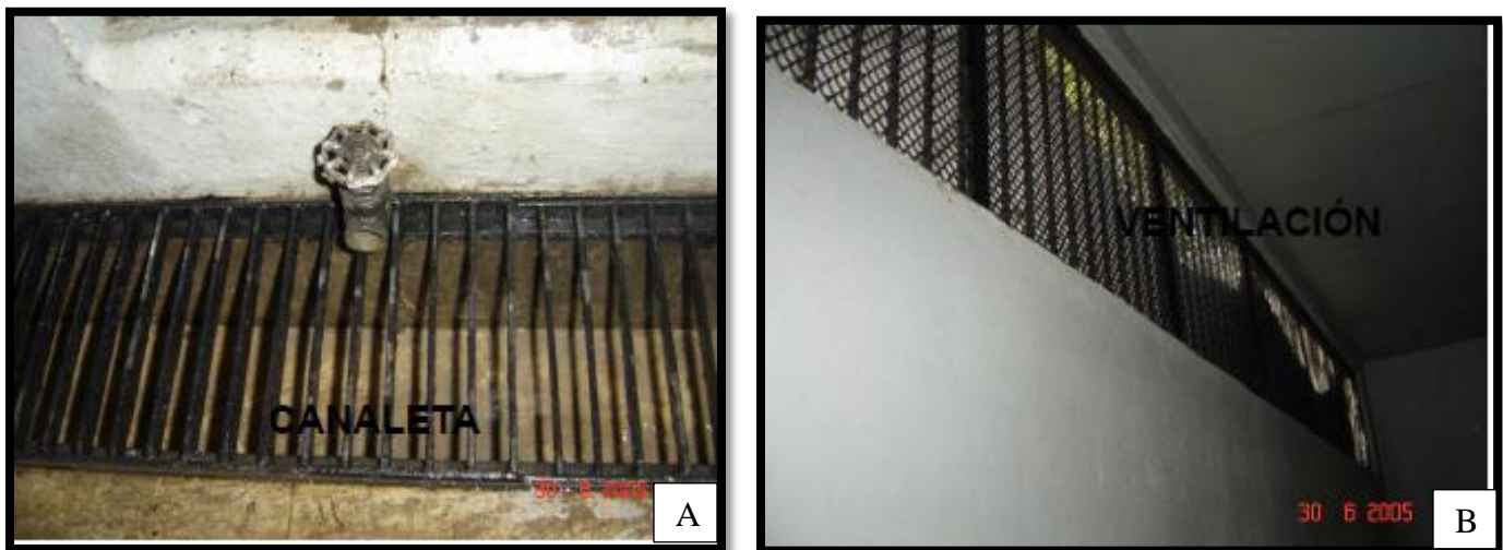
Imagen 28. A. El piso del área de hospitalización deberán de tener 2% de inclinación y dar hacia la canaleta; B. La ventilación estará en la parte superior de los encierros y con malla para protección.
